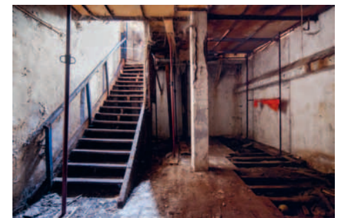
Viel zu tun: Auch im Innern sind die einst stolzen Häuser verfallen
